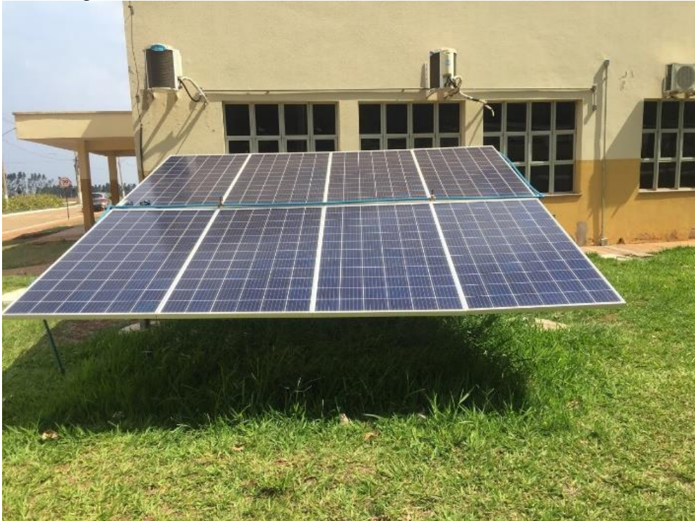
Figura 4. Imagem dos módulos fotovoltaicos montados
